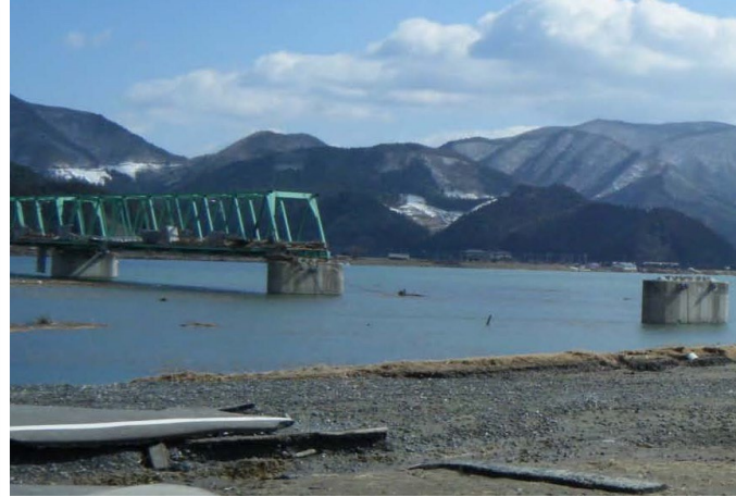
津波被害（北上大橋）
